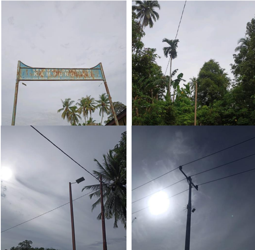
Gambar 6. Lampu PJU Terpasang di Nagari Lagan Mudik Punggasan
