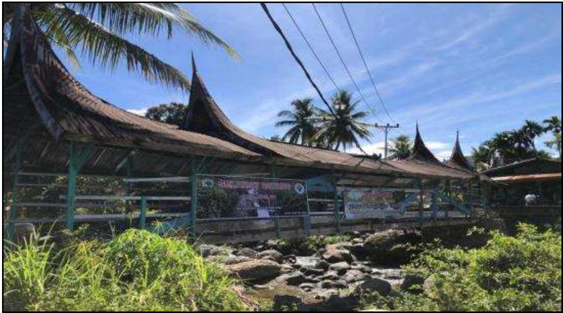
Gambar. 2 Kondisi jembatan Ba Atok sebelum direnovasi
